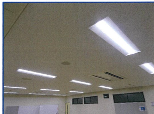
【野球場会議室照明LED化】
