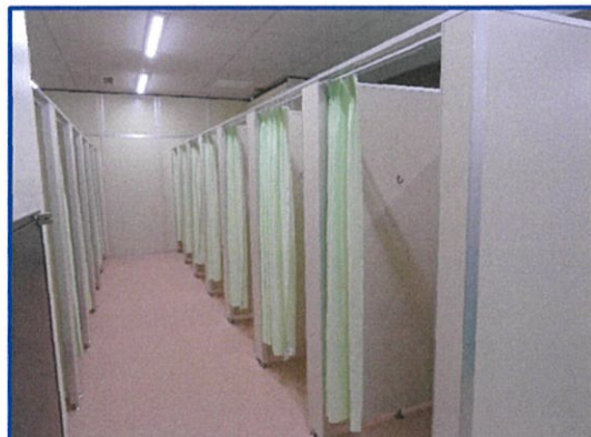
【老朽更衣ブースの撤去・更新, 床面張替え (水泳場 男女共)】
